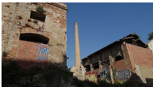
Figura 9 – La central energética de Can Ricart, con la sala de la máquina de vapor y la sala de calderas
